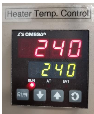
Figura 6. Controlador de temperatura ubicado en la parte posterior del RIG-150
