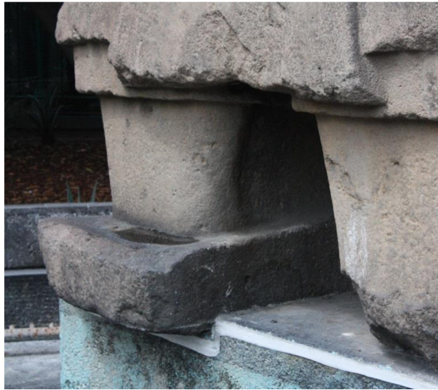
Figura1.10. Agua estancada en la parte superior del pie derecho.
