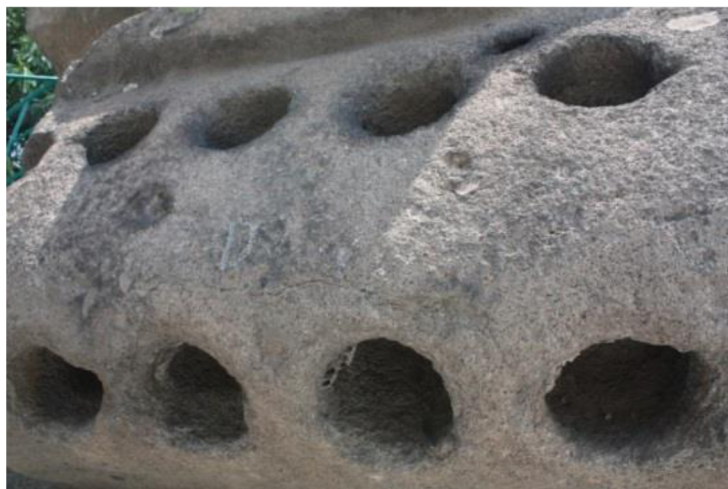
Figura 1.27. Fisura activa localizada en los orificios de la “boca” del Tláloc.
