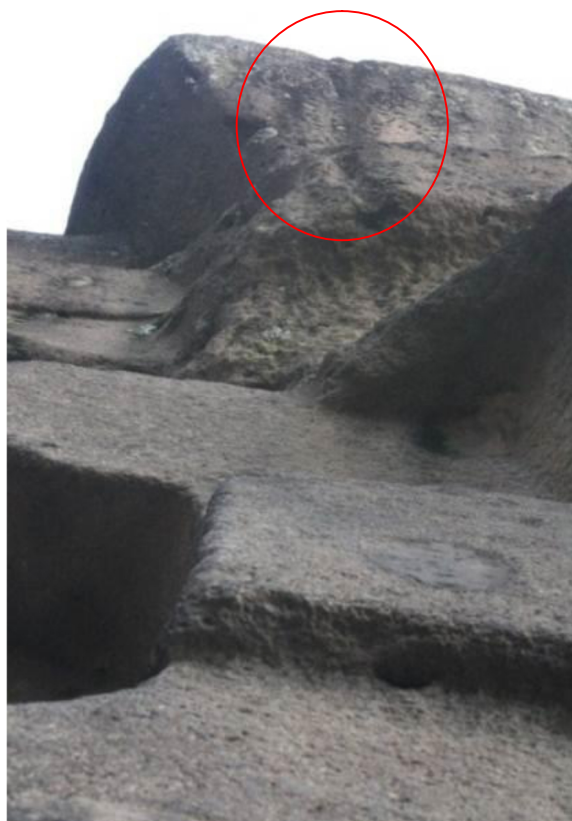
Figura 1.29. Marcas por escurrimientos de agua.
