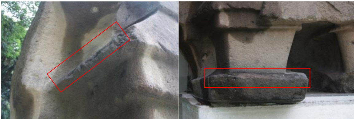
Figura 1.28. Fisuras relacionadas con áreas de escurrimiento, evaporación y acumulación de agua de lluvia.
