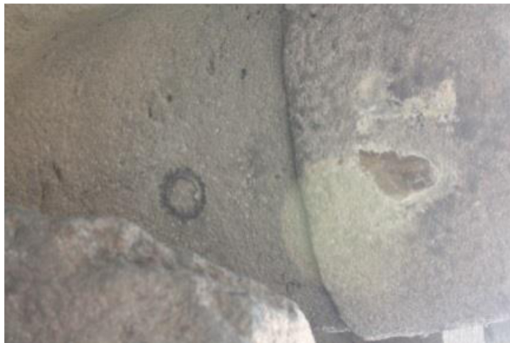
Figura 1.35. Concreciones y manchas en superficie.
