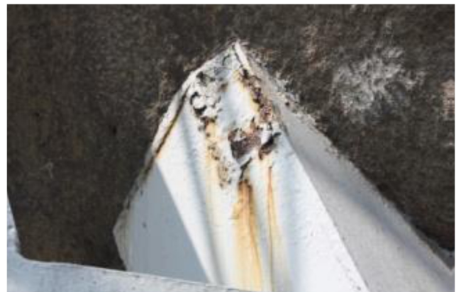
Figura 1.25. Detalle de corrosión activa en el soporte auxiliar ubicado en el reverso del monolito.
