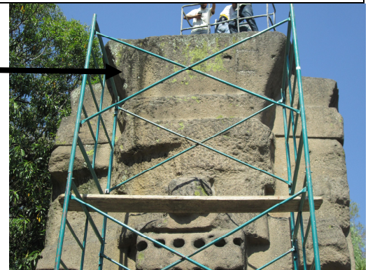
Figuras 4 y 5 Filtraciones y escurrimientos en el monolito.
