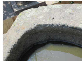
Figura 3. Filtraciones por capilaridad
