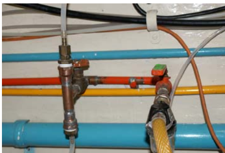
Figura 4. Válvulas principales de entrada de aire comprimido para suministro de presión de la válvula de compuerta.
